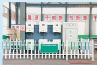
光伏发电设备
